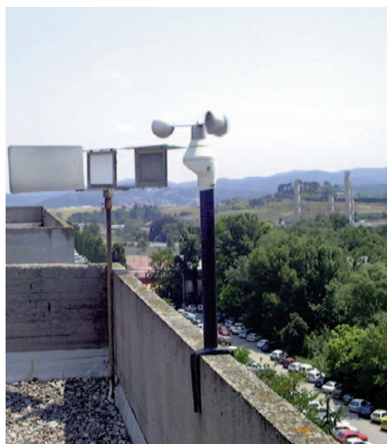
FIGURA 5. Captador Cour y anemómetro totalizador.
